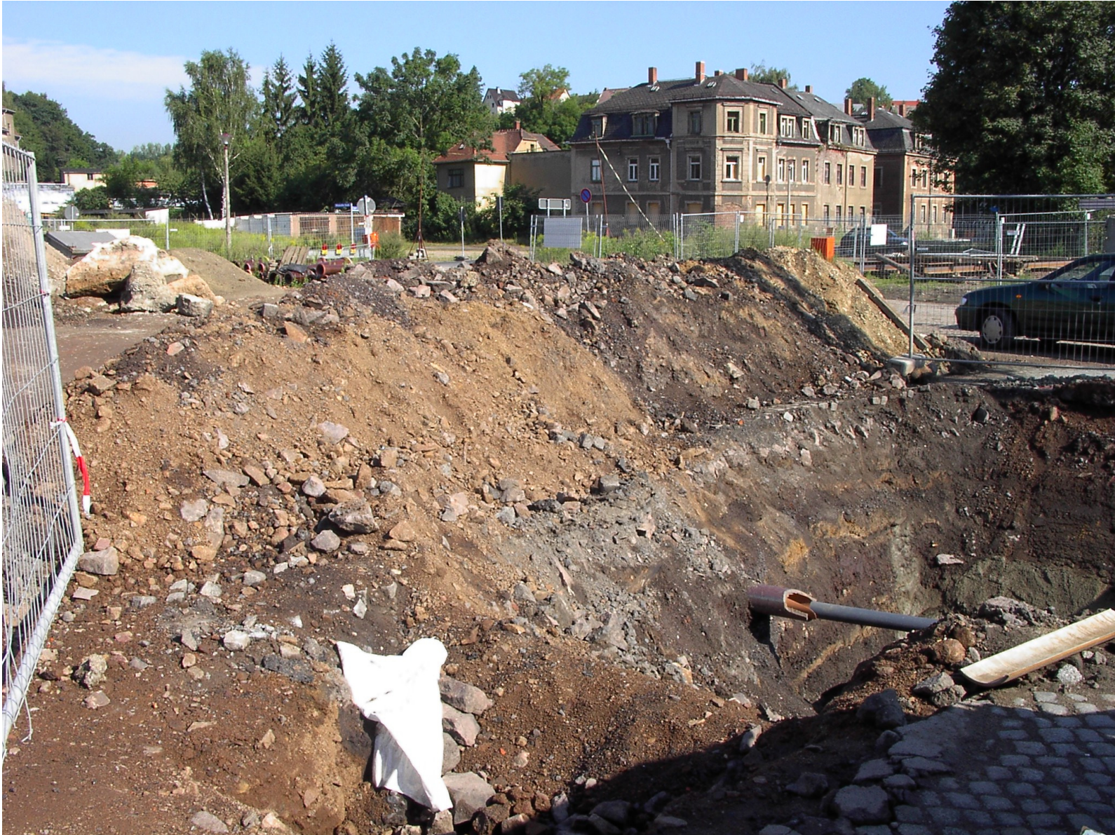
Freital: Kontaminiertes Material in alten Leitungsgräben
