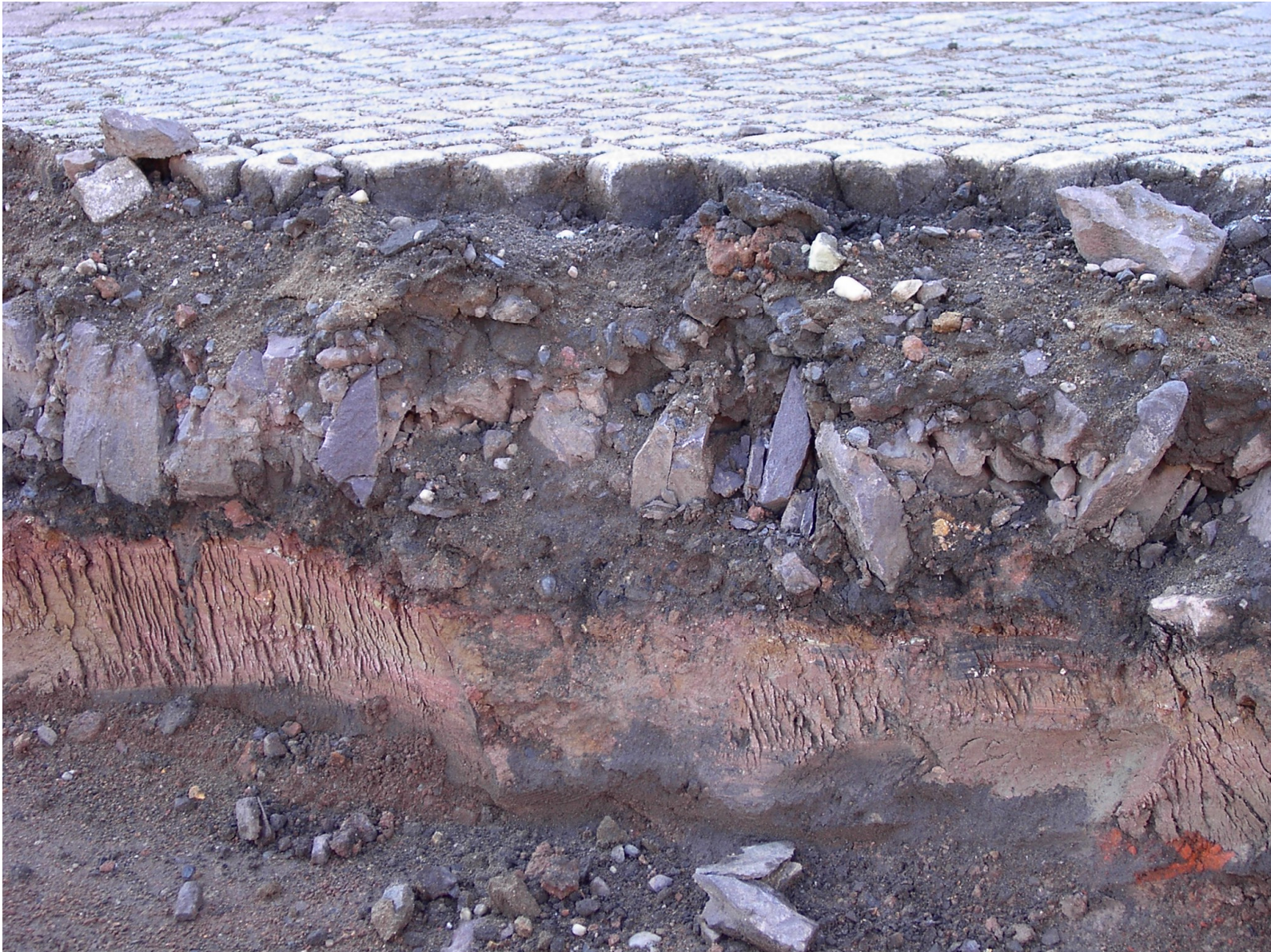
Nordtangente Freital: Radioaktiv kontaminiertes Material im alten Straßenschotter
