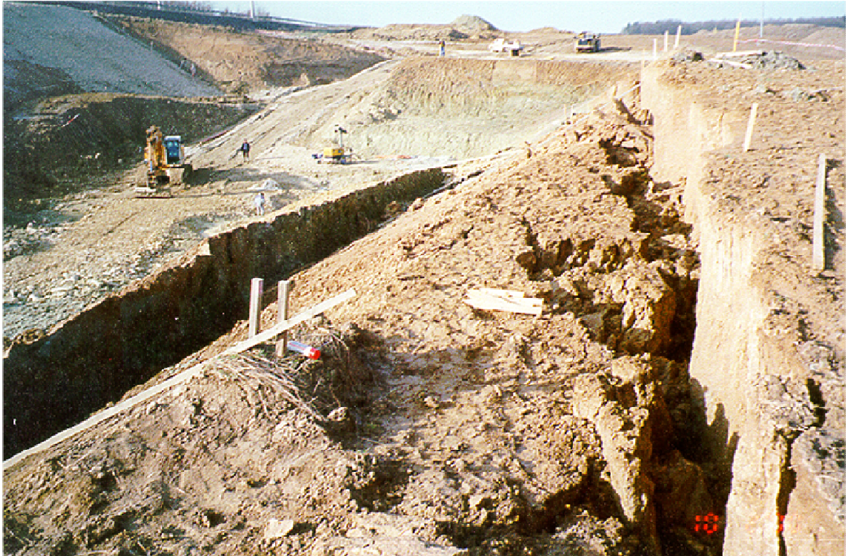
Abb. 2: Böschungsbruch während der Einschnittsherstellung
