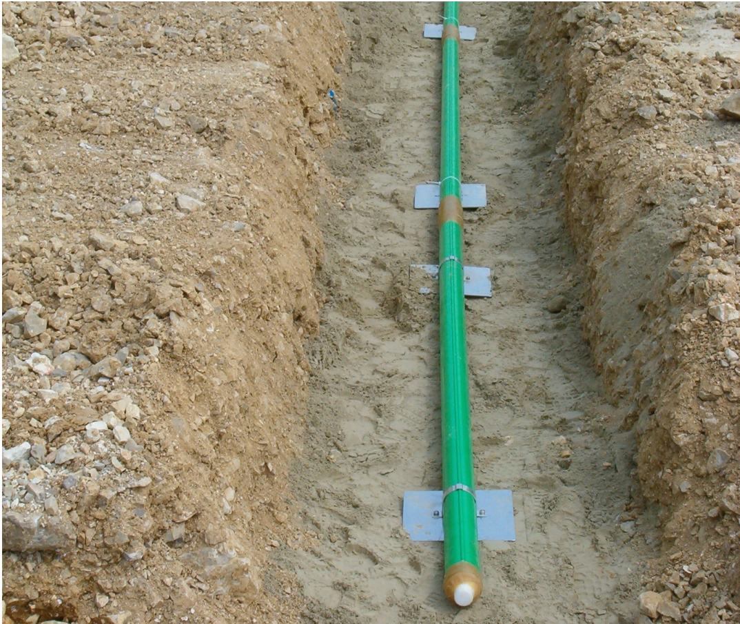
Abb. 4: Horizontalinklinometerrohr im Einbauzustand
