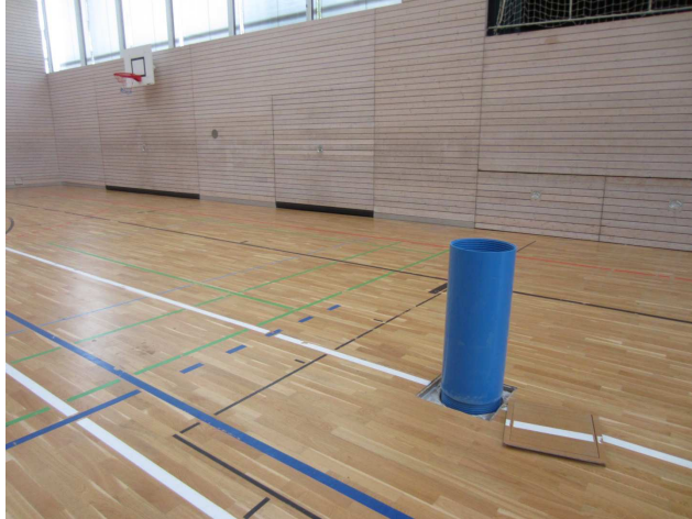
Druckentlastungsbrunnen mit 1 m Aufsatzrohr
