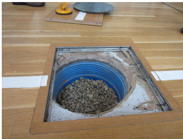
Druckentlastungsbrunnen im Parkett der Sporthalle
